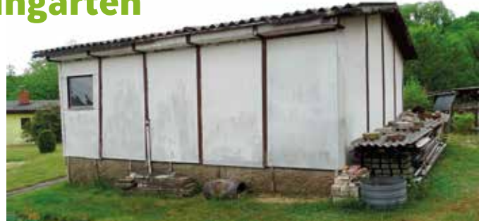
Eine klassische Laube aus DDR-Zeiten. Dach und Wände sind mit Asbestplatten verkleidet. Hinter der Laube wurden beschädigte Wellasbestplatten als Abdeckung für Baumaterial verwendet. Asbestfasern lösen sich zusammen mit abblätternder Farbe und durch das Beschweren mit Steinen. Hier kann nur noch alles fachgerecht entsorgt werden, um Gesundheitsschäden vorzubeugen!
