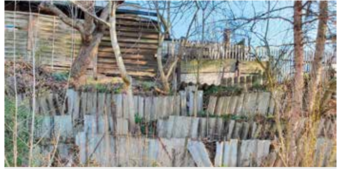
Zerteilte Wellasbestplatten wurden hier zur Hangbefestigung/Terrassierung verwendet. Durch Hangdruck sind ein Teil dieser Platten über der Erde abgebrochen. Das ist Umweltverschmutzung pur!
