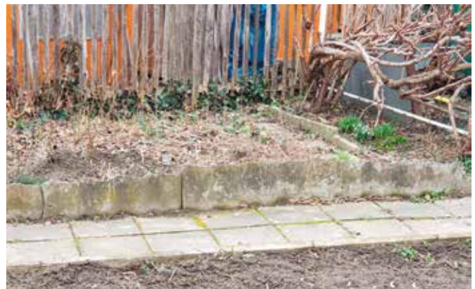
Bei diesen Wegefassungen aus Wellasbestplatten kann man deutlich Beschädigungen erkennen. An den Kanten und den Flächen können sich Fasern lösen, die schlimmstenfalls bei der Beet- und Wegpflege eingeatmet werden.
